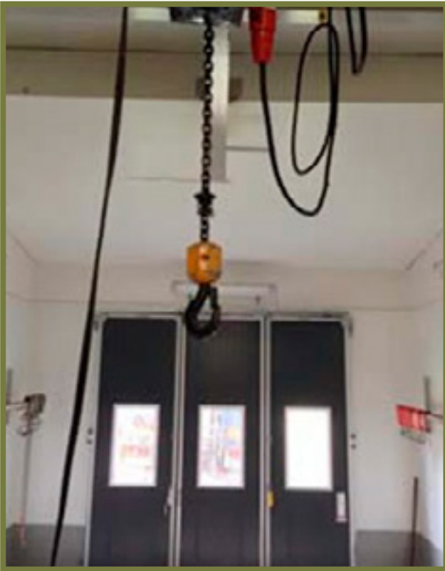
Mottagningsrum med kyla, bild tagen inifrån
