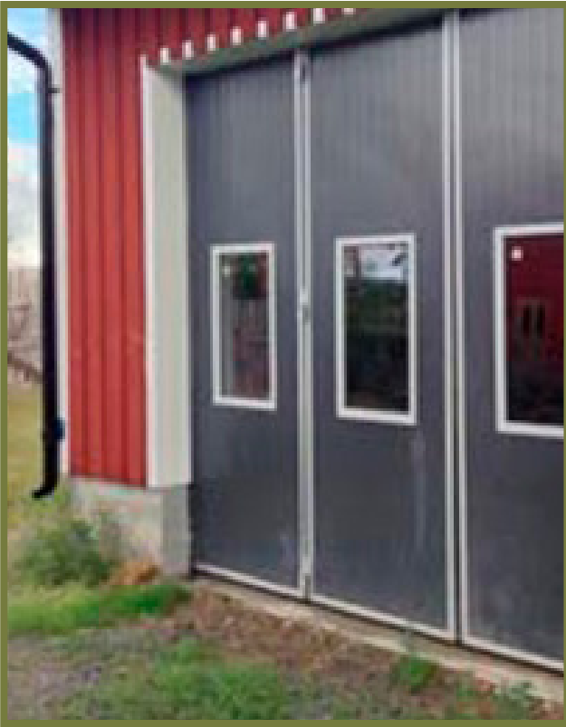
Mottagningsrum med kyla, bild tagen utifrån
